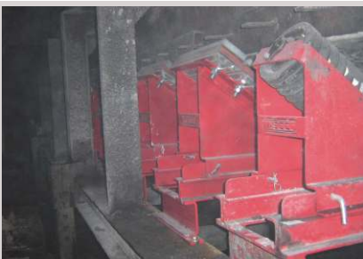
Leitos de impacto modular/com roletes intermediários instalados em uma mina de carvão subterrânea.
