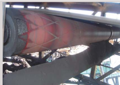
Tru-Trainer de retorno duplo (poliuretano de retorno duplo) instalado em um sistema de transporte de carregamento de 96" (2439mm) de carvão.
