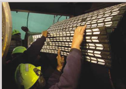
Revestimento Arrowhead sendo instalado nesta transmissão em tandem nesta mina de carvão.
