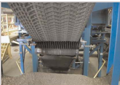
Limpador Chevron eliminando quaisquer resíduos deixados no transportador de fragmentos de madeira.
